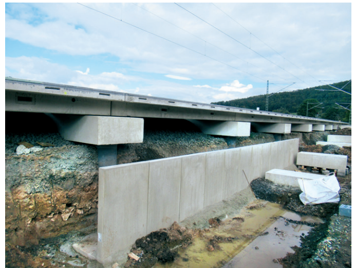
Abb. 2: Tiefgründung mit Bohrpfählen und Halffertigteil-Kopfbalken im Bahnhofsumfeld von Melsungen zur Aufnahme des modularen Bahnsteigs
