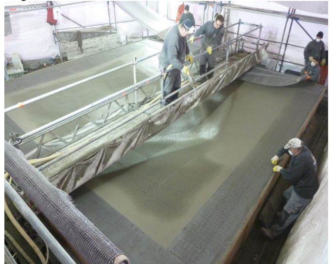
Bild 11 Lagenweise Herstellung der Textilbetonschale in Spritzbetonweise Manufacturing by layers of the textile-reinforced shell
