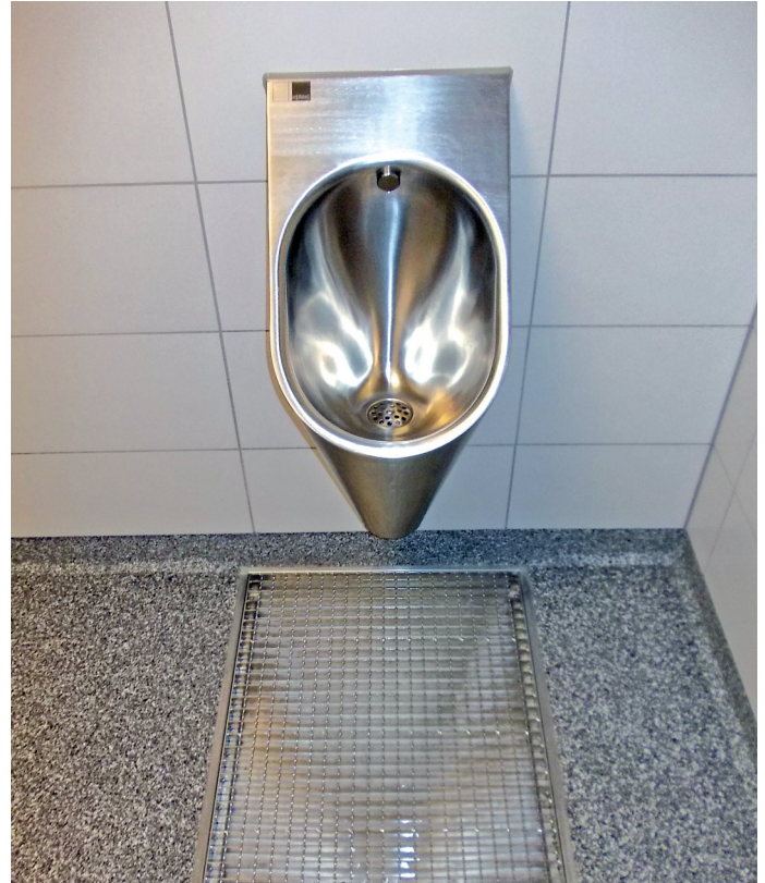
Pfützenbildung ist unmöglich: Unter dem Urinal sorgt eine Unterflur-Bodenwanne, die regelmäßig gespült wird, für dauerhafte Sauberkeit.
