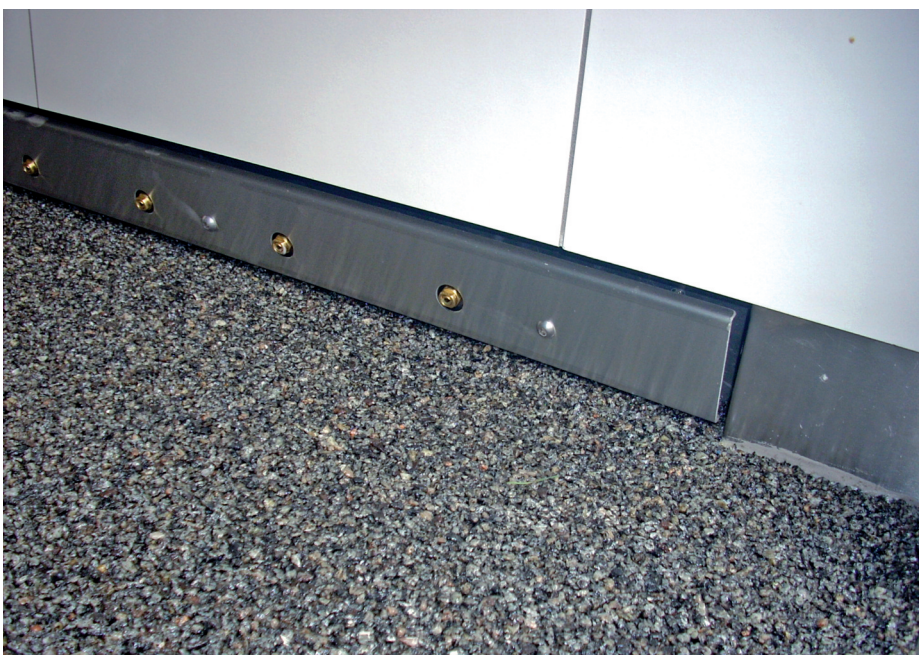
Bei der Standard-Fußbodenreinigung spritzen in die Wand eingelassene Edelstahldüsen das Wasser im flachen Winkel über den Boden.
