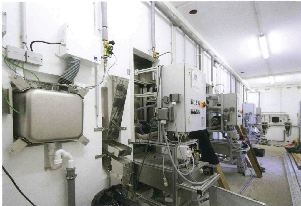
Abb. 6 (Bild gegenüber) Eine Nutzereinheit von innen; die Räume weisen grundsätz- lich keine Urinale auf. Nach jeder Benutzung sperrt eine Steuerung die jeweilige Au- Bentür und das WC wird kurz gereinigt. Hierzu wird dasselbe über eine Mechanik nach hin- ten in die Wand gezogen und dort abgespült
